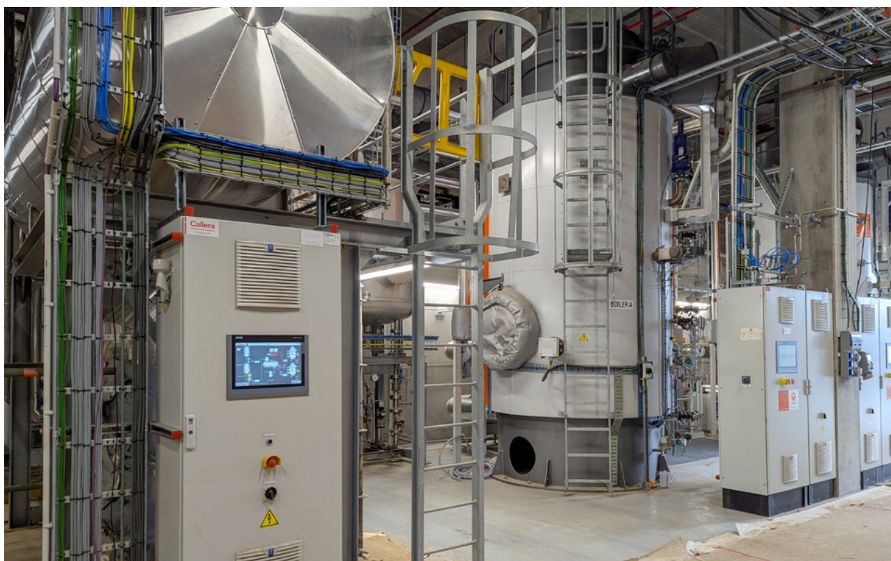
2 e-boilers van elk 5 MW en 7,5 T/h stoom, incl. balance of plant
